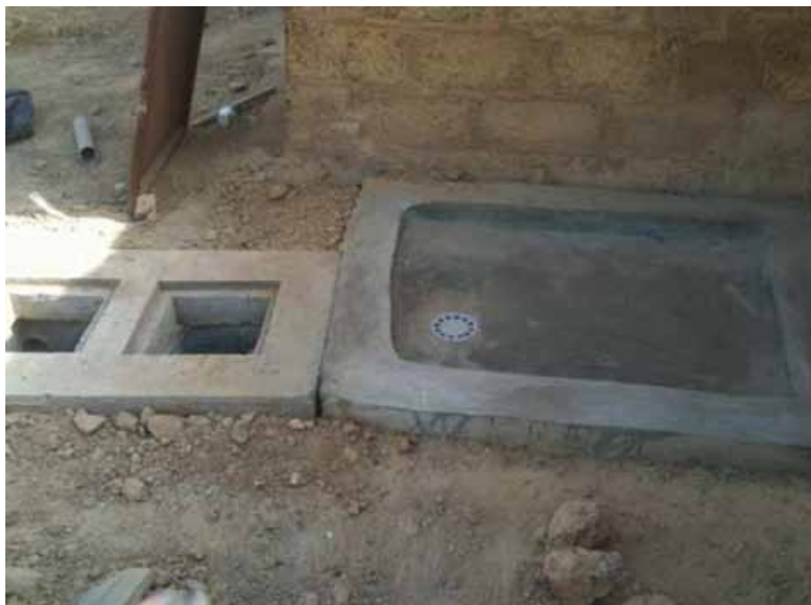
Vidoir dégraisseur en construction dans une oncession
