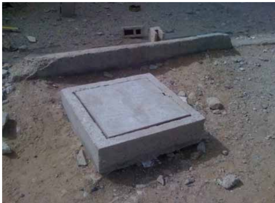
Regard de visite sur le réseau
